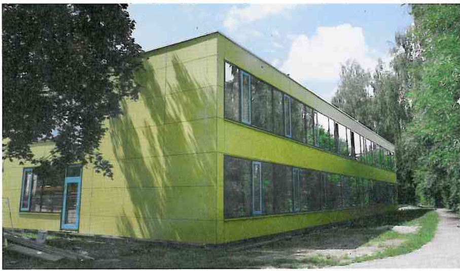
▲ Die Oster- und Pfingstferien hatten genügt, um die alte Fassade durch die neue zu ersetzen
