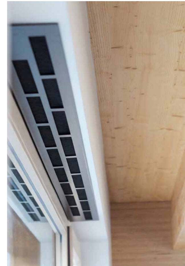
Klimatisierung im Fenstersturz ermöglicht freie Holzdecken und reduzierte Installation
