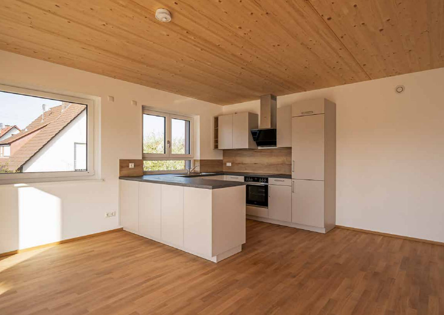
Ganzjährig behagliches Raumklima – auch bei großen Fensterflächen. Das Raumluftgerät WINDOW „verschwindet“ im Fenstersturz (Bild: Eckhart Matthäus)
