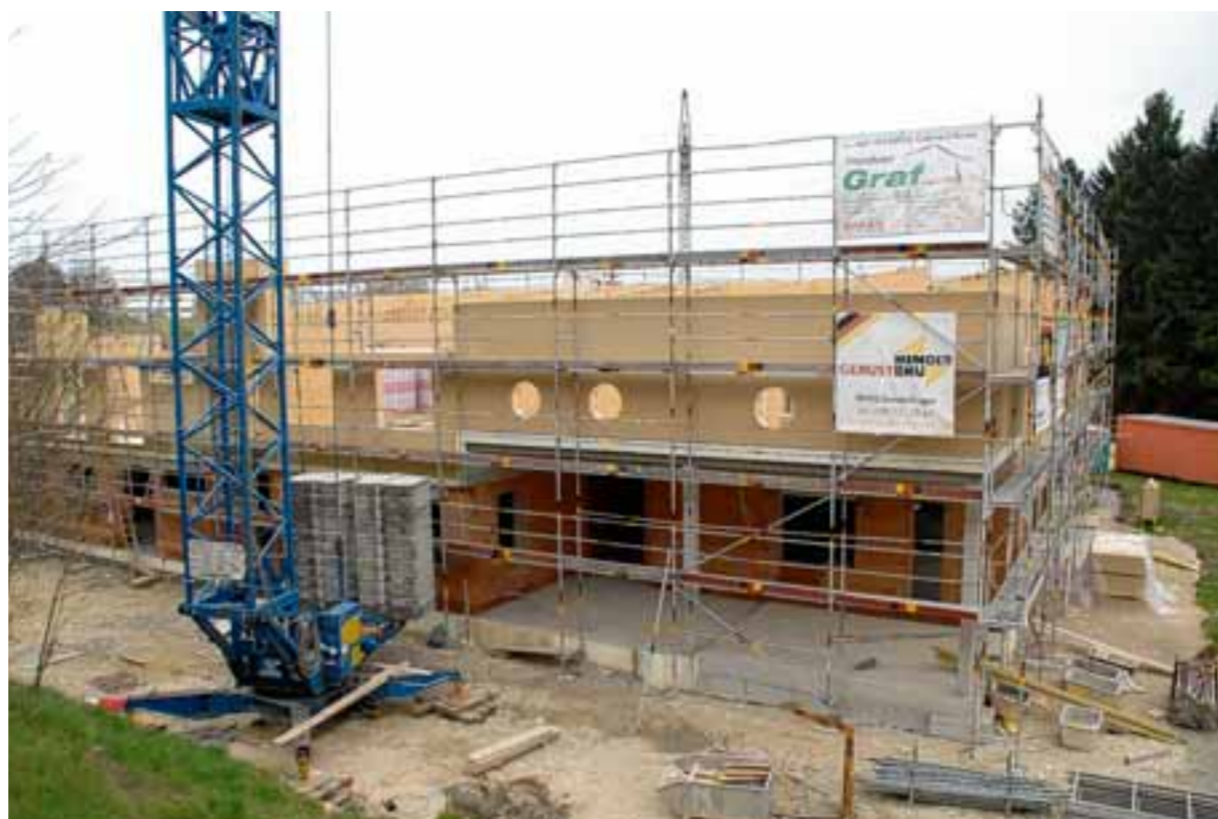
Rund 4,3 Millionen Euro kostet der Neubau des Kindergartens am Klosterhof in Dillingen. Zwischenzeitlich sind die Bauarbeiten im Obergeschoss angelangt. Fotos: von Neubeck
