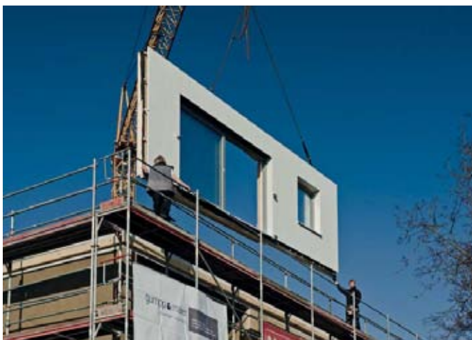
Mit dem Kran werden die großen Fassadenelemente von oben hinter das Baustellengerüst gehoben
